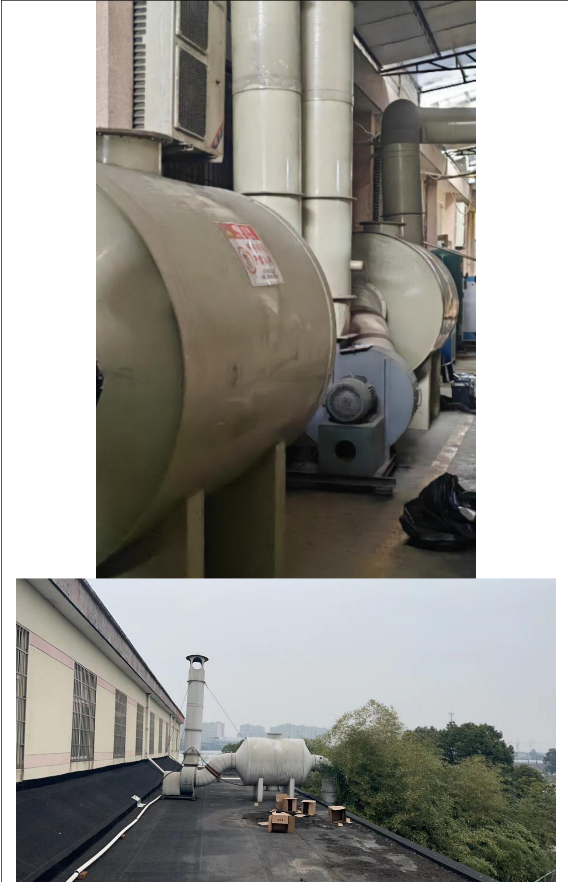
图 3-3 废气处理设施
